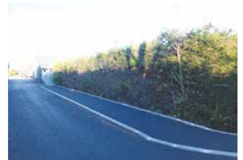
Réalisation d'un trottoir rue de la Piquette par la Communauté de communes des Pieux.
