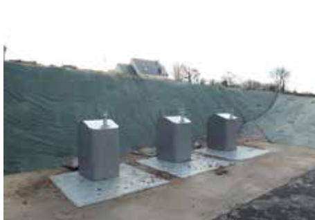
Mise en place de containers de tri en apport volontaire au niveau de la RD4. Fin des travaux prévus en janvier.
